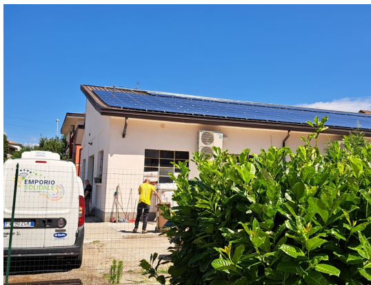
63 kWp – Emporio solidale In fase di allaccio
